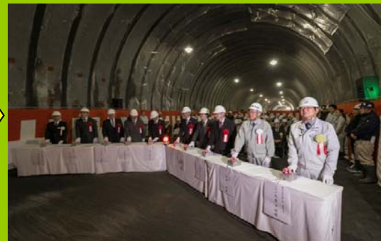
ご来賓が一齐にボタンを押して、貫通発破です。発破音が坑内に響き渡り、発破完了！！
